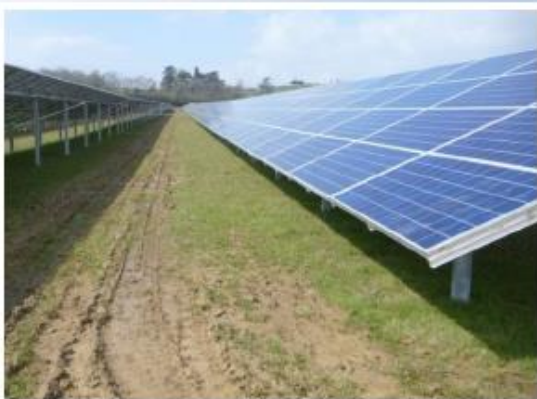
Centrale Solaire de CONDOM Département : Gers (32) Puissance électrique : 10 000 KWc Mise en service : Mars 2013
